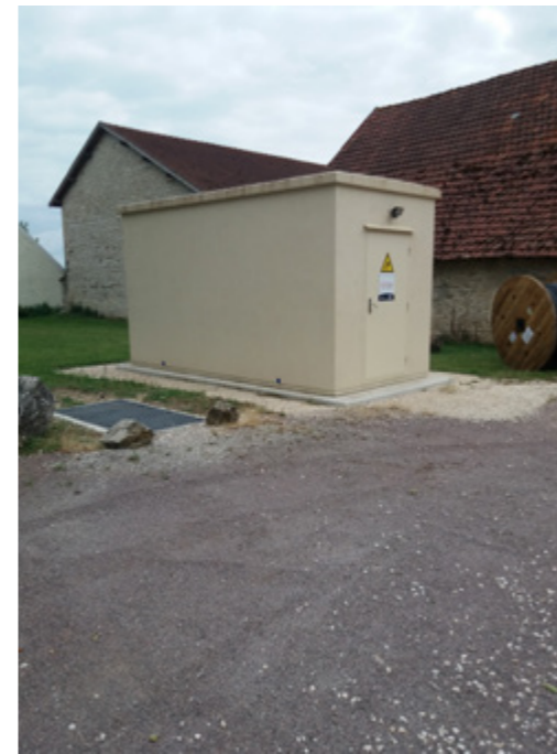
Nœud de Raccordement Optique (NRO) implanté place des Marronniers
