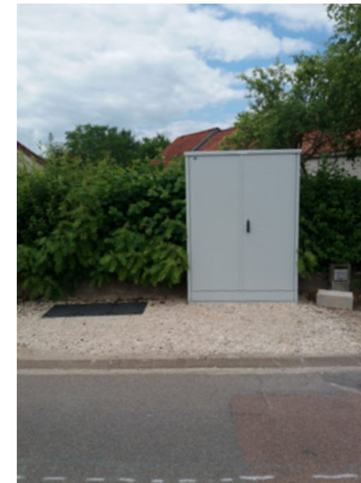
Sous Répartiteur Optique (SRO) installé route de Fontaine-Française
